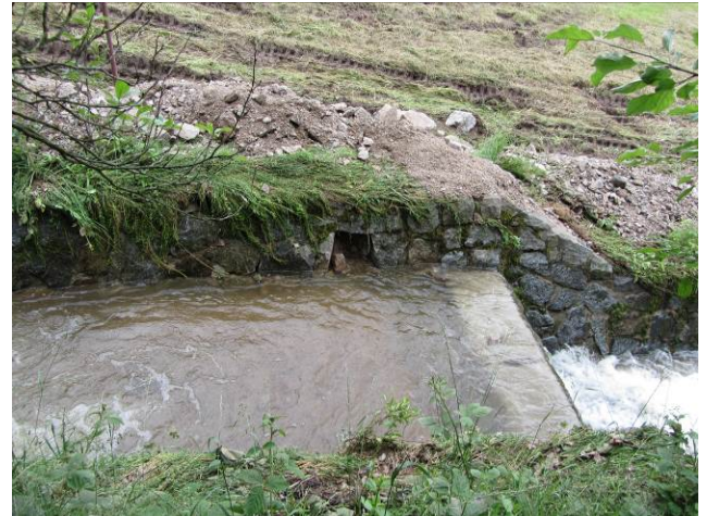
Überlaufen im Bereich Sohlschwelle
